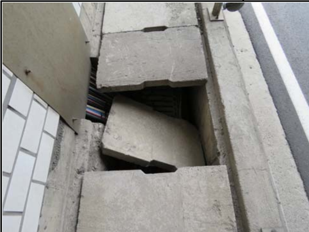
내 용 J0 공동구 덮개 탈락
