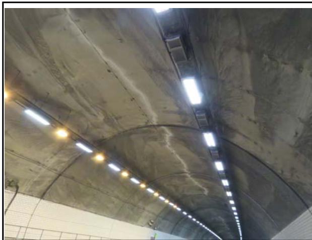
내 용 조명설비 전경
