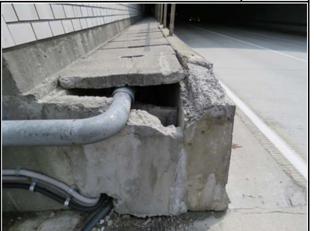
내 용 J140 공동구 옥내 소화전 송수구 파손
