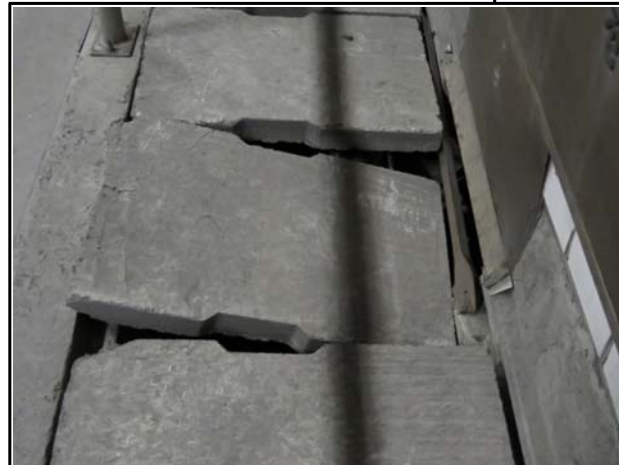
내 용 J105 공동구 덮개 이탈
