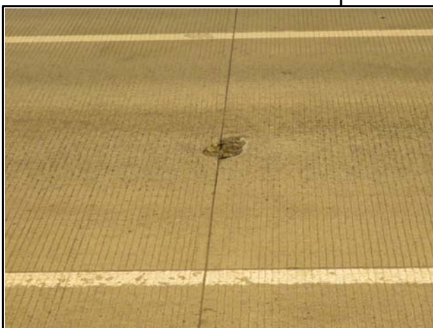
내 용 J7 줄눈부 포장 파손 A=0.3x0.2
